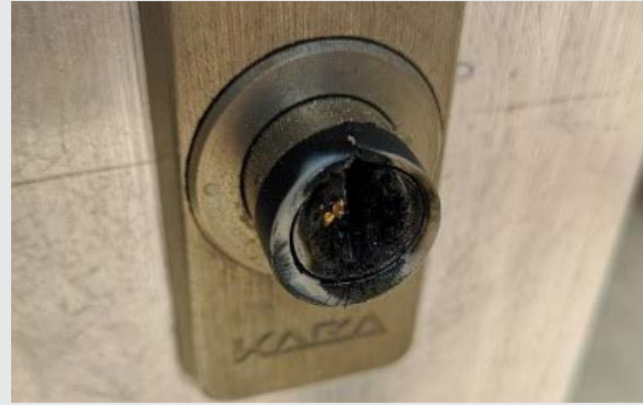
Cylindre brûlé au Centre Sportif
