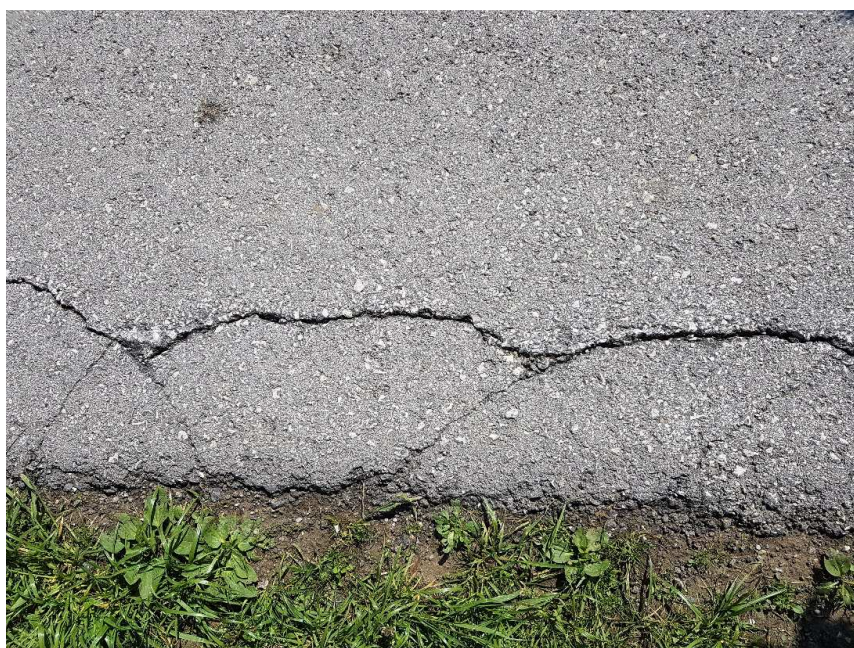
Fissures dans l'enrobé nouvellement posé sur la route L'Auberson – La Prise Perrier
