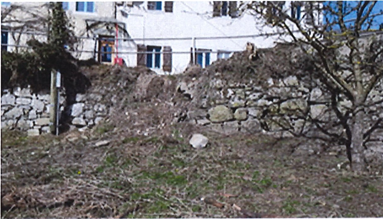
Effondrement partiel du mur existant
