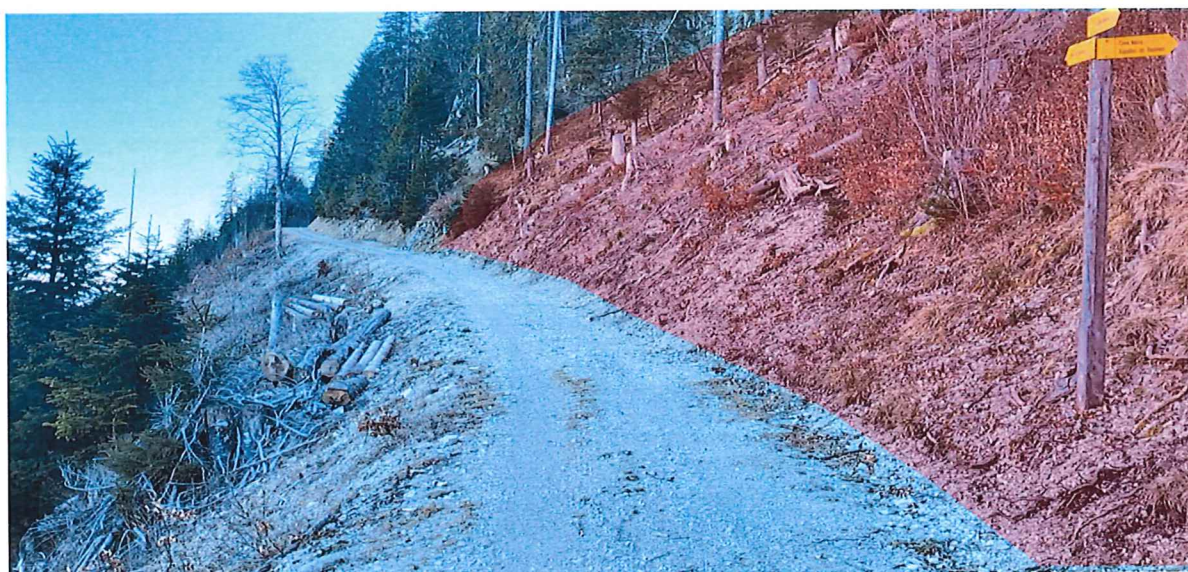
Zone d'éboulis nécessitant une mesure de lutte contre l'érosion superficielle; Illex-04.2024
