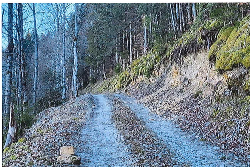
Tronçon du chemin du Saut de l'Eau présentant un éboulis de la paroi amont, illex 2023
