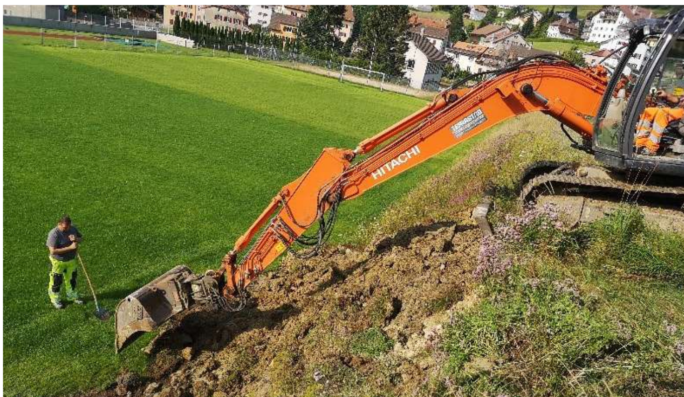
Glissement de terrain Centre Sportif
