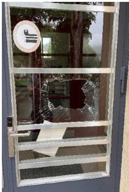
Vitre cassée au Collège de la Gare
