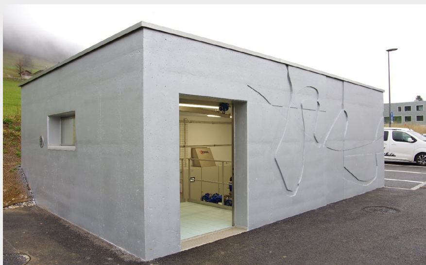
Vue extérieure de la station de pompage de l'hôpital, pour l'amenée d'eau à la Gittaz
