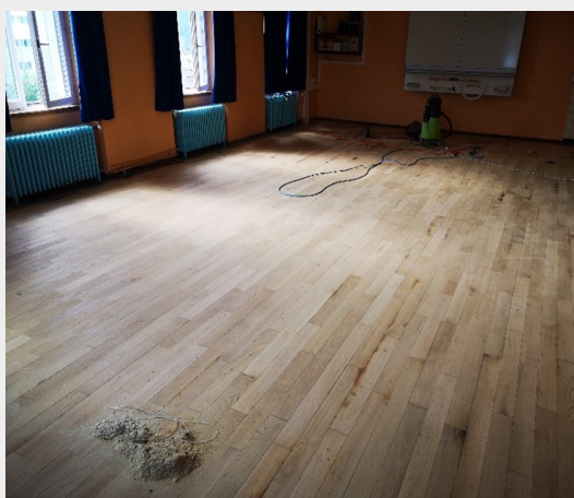
Fuite du chauffage au Collège de la Gare
