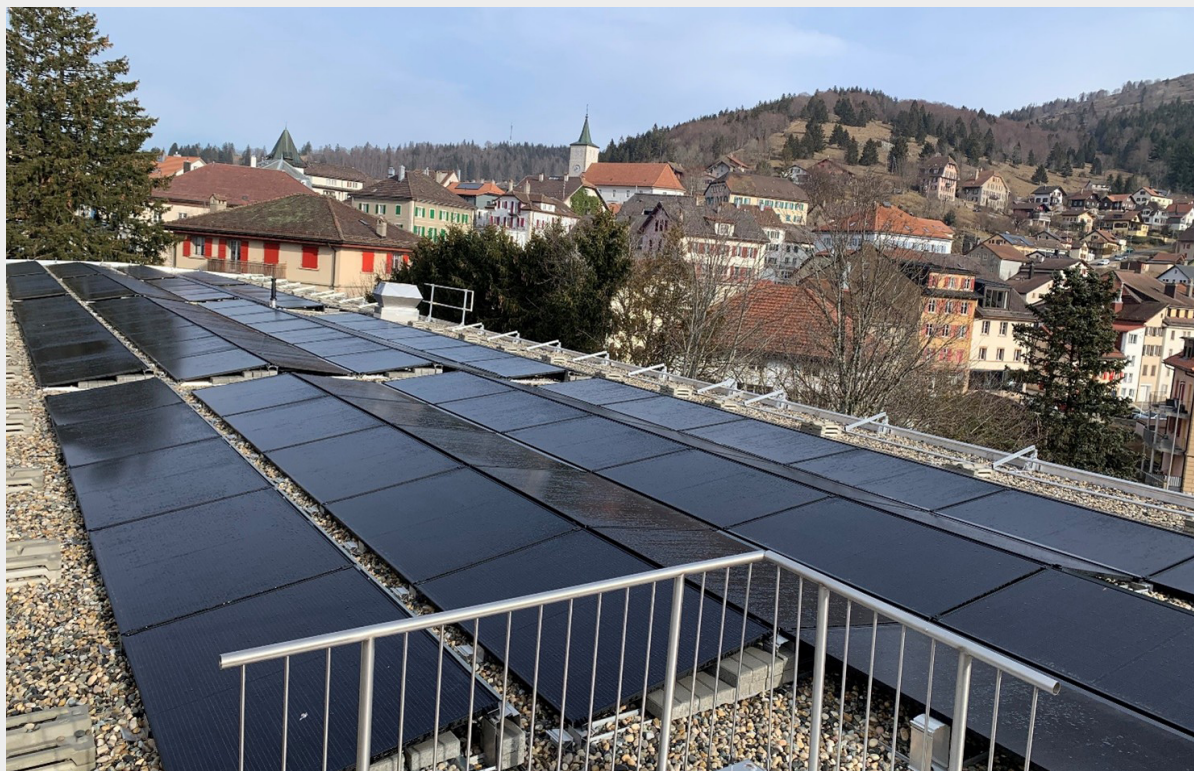
Installation photovoltaïque sur le bâtiment MuMAPS
