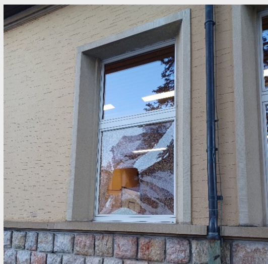
Vitre cassée au Collège de la Gare
