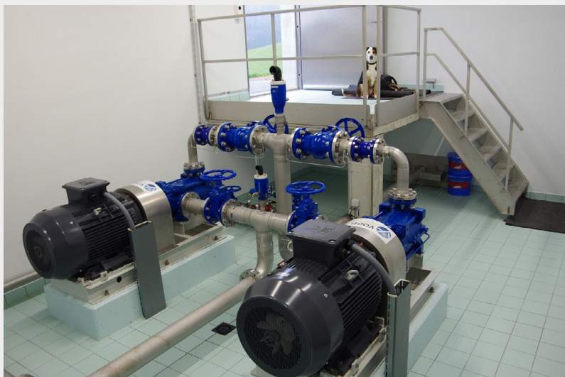
Vue intérieure de la Station de pompage Les pompes peuvent fournir chacune 1'500 l/min d'eau aux Gittaz
